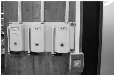
天窓開閉用の手動式装置
