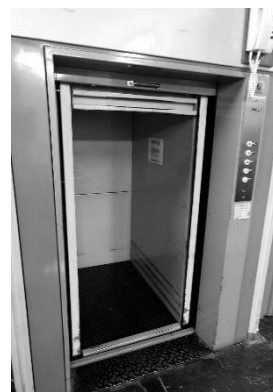
小荷物専用昇降機(ダムウェーター)
